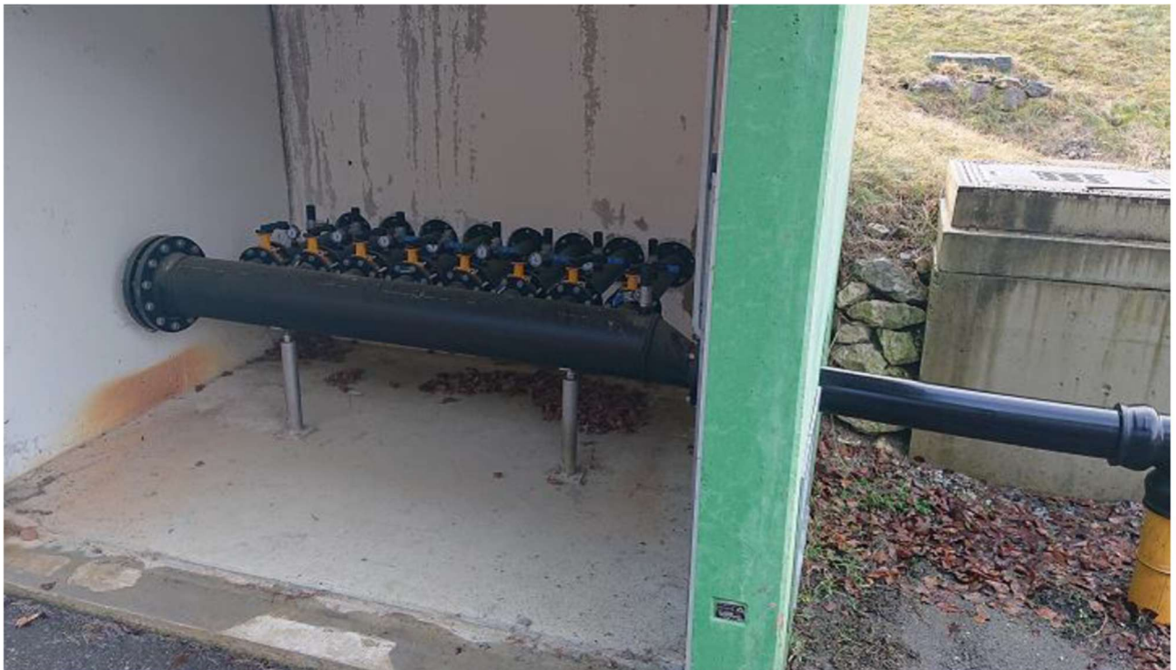
Verteilerstation Entgasung der Deponie Sieghart
