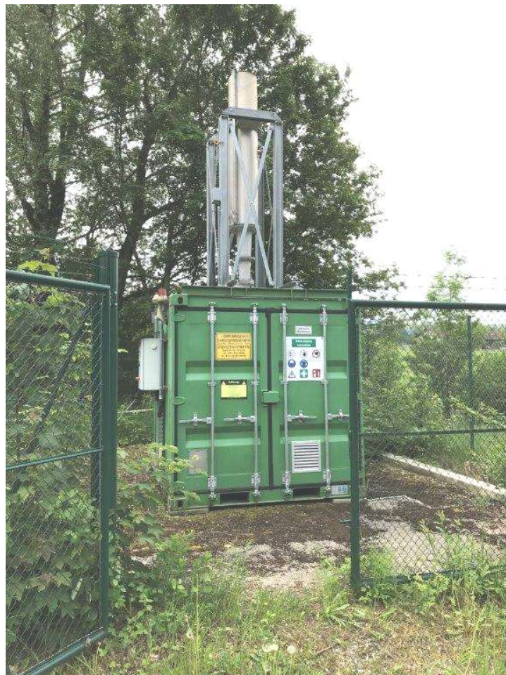
CHC-Konverter (Kohlenwasserstoffkonverter für Deponien) auf der ehemaligen Deponie Urschalling
