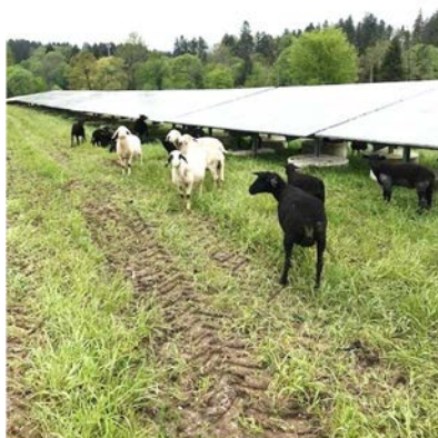
Photovoltaikanlage (Erstellung Juni – Sept. 2022) auf der ehemaligen Deponie Urschalling
